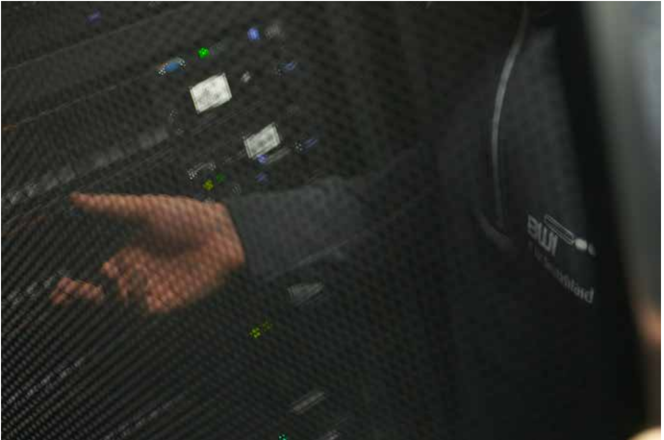
Mitarbeiter der BWI vor einem Serrack in einem Rechenzentrum
